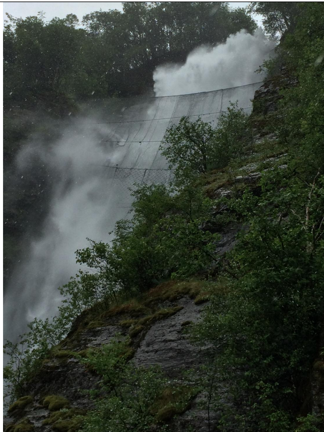
Dato: 12. juni 2014. Vannføring 3,3 m 3 /s, ca. 2 x slukeevne. (Foto: Maria Dahl) Steinsprangnett får noe påkjenninger allerede på denne vannføring.
