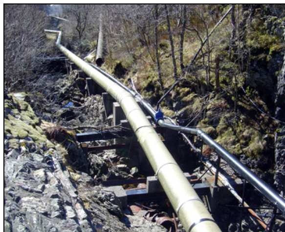
Figur 6. Utløpselven fra Husdalsvatnet har vært tørrlagt i en årrekke. Lerøy Vest AS avd. Bjørsvik har vannforsyning både fra kraftverksrøret (ledning til venstre på bildet) og via en egen 315 mm PEH reserveledning (til høyre).
