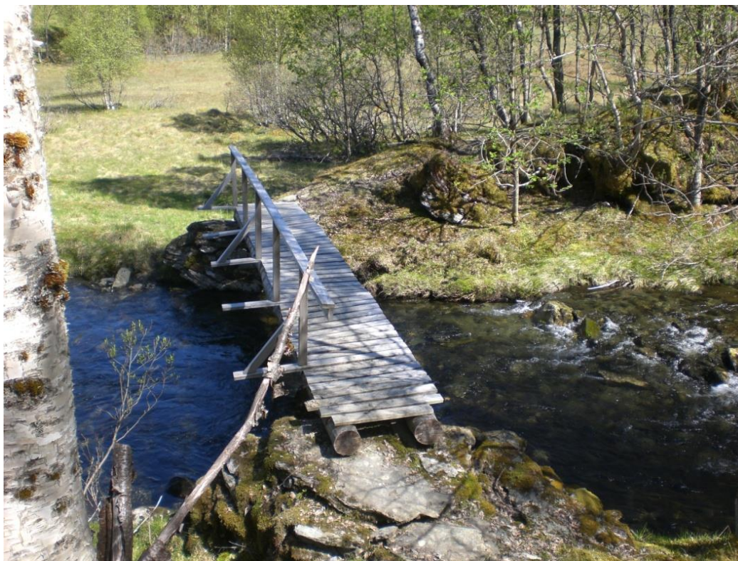
Bilde 9 b. Samme sted som 9a. 30.05.10 vannføring ca 400 l/s
