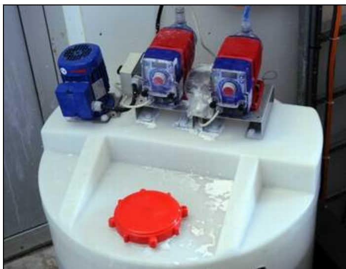
Figur 6. Vannet luftes før bruk (over) og tilsettes silikat (til høyre) før det fordeles til anleggets ulike avdelinger og kar.
