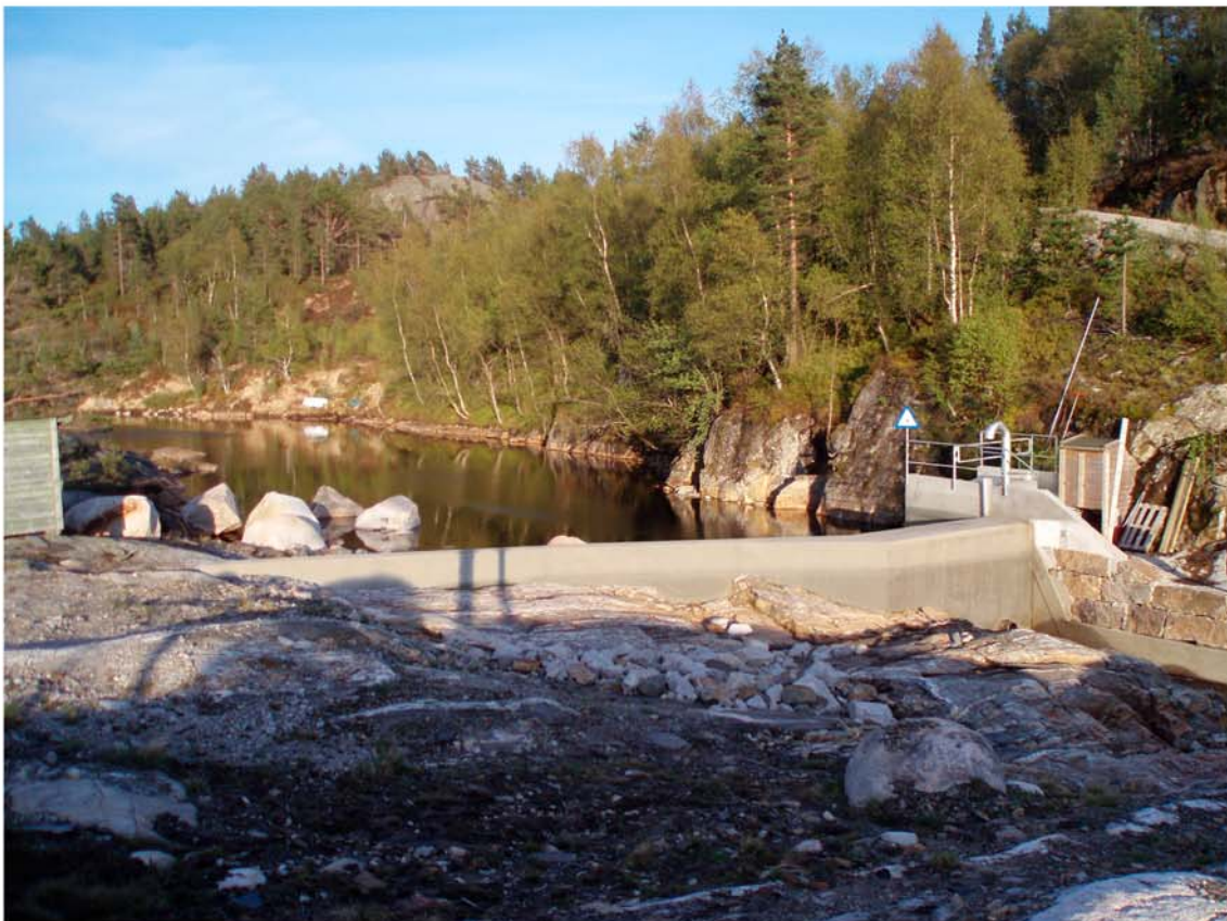
Bildene viser før (øverste) og etter (nederste) heving av dam med 0,5 m, bildene tatt mot sydøst
