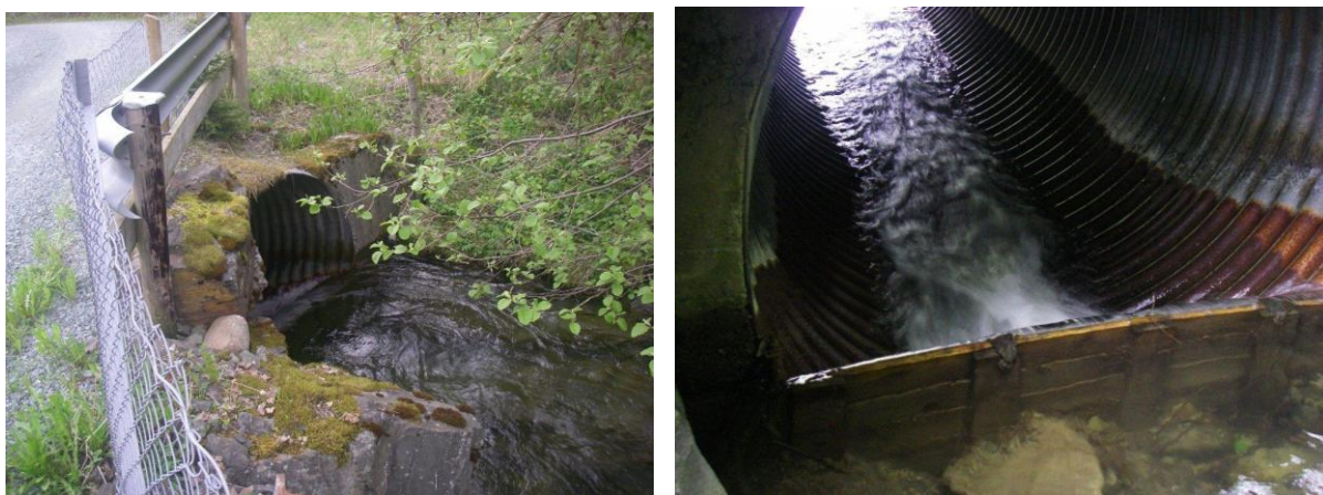
Figur 7. Vandringssperre for anadrom fisk under veikulvert nedstrøms kraftstasjon.
