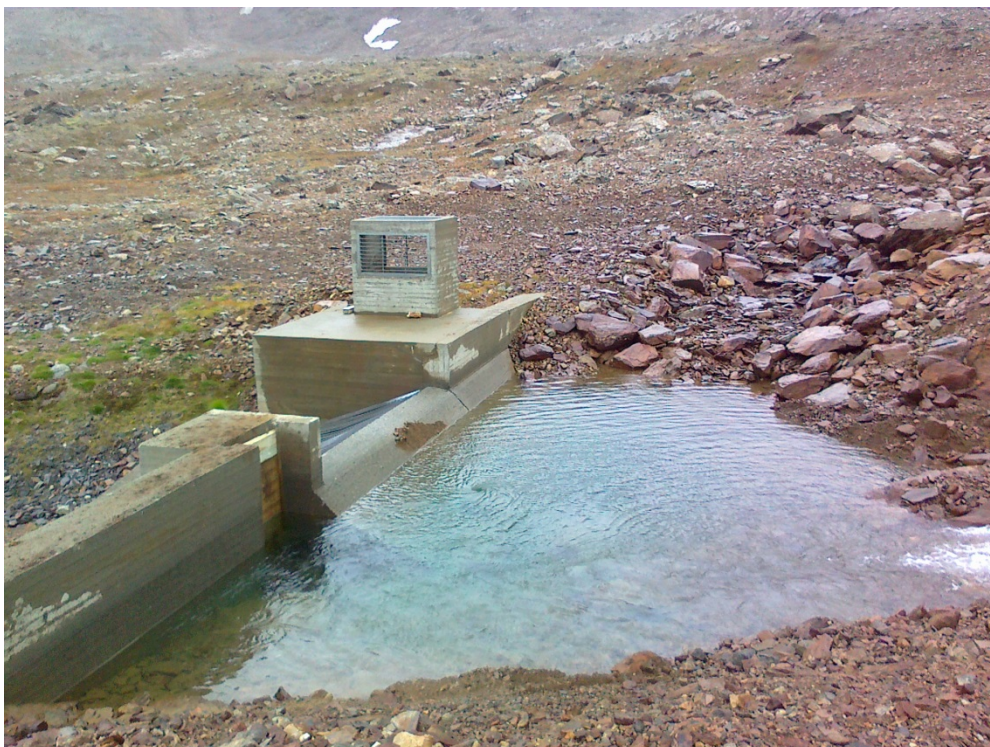
Bilde 3-1: Bekkeinntak G1 i Lavkadalen. Tyrolerinntak / overfallsinntak.
