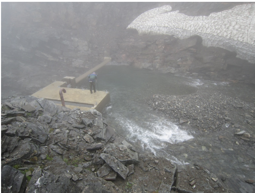
Bilde 3-2: Bekkeinntak B5 i Ørndalen, Guolas kraftverk. Sideinntak.
