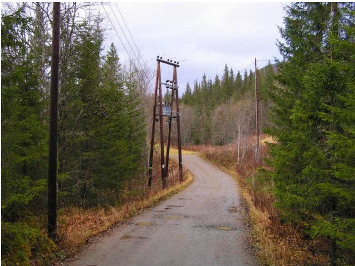
Bilde 5.1 Eksisterende kraftlinje ca 200 m fra stasjonsområdet
