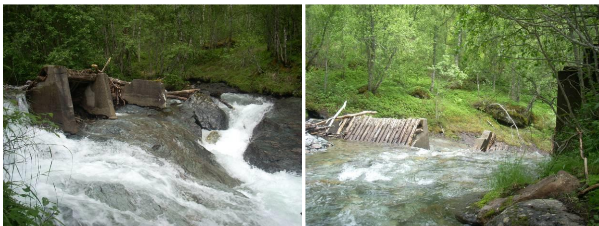
Figur 13: Bildene over viser vandringshinder for anadrom fisk ved ca kote 50 med gammel, murt dam. Fotos: Ole Roer
