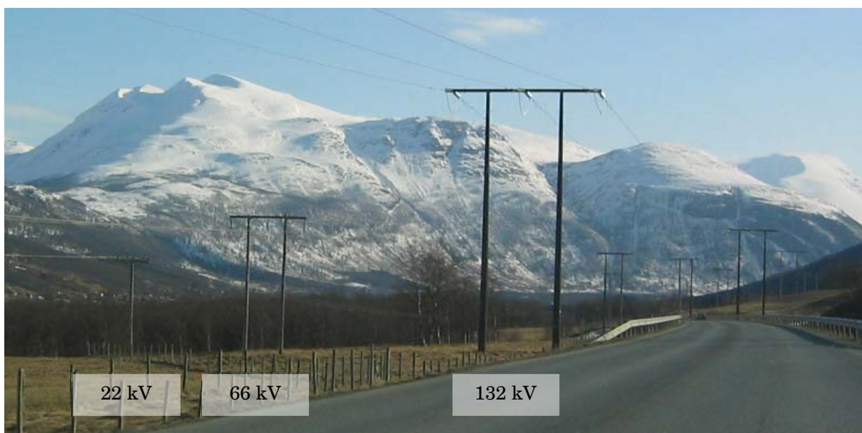
Figur 6-5: Eksempel på tremaster i kraftlinjer med 22 kV, 66 kV og 132 kV spenning i Nordkjosen i Troms
