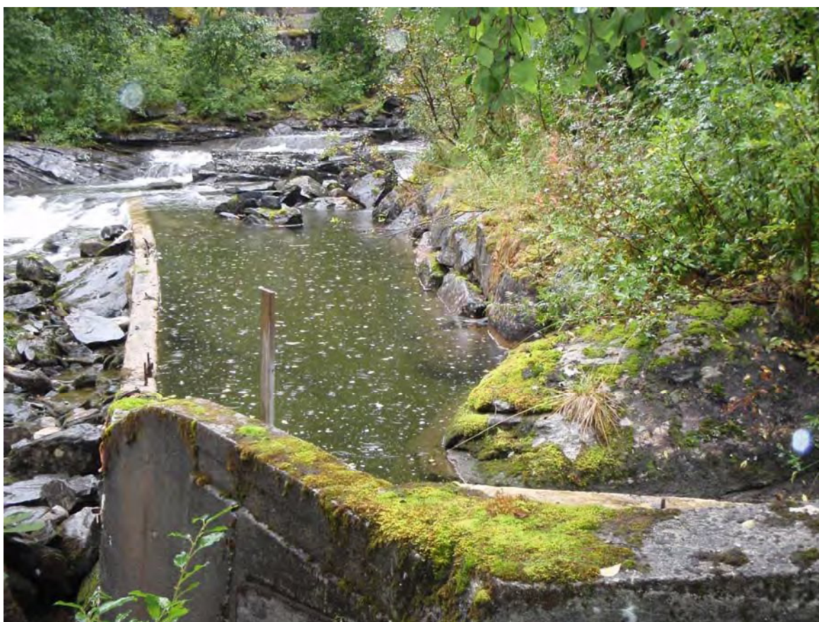
Inntak Ytre Foldvik vannverk
