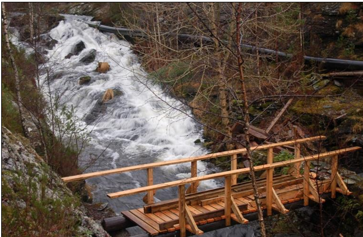
Figur 4b. Tilførselsledningen til anlegget ligger delvis i kanten av elven og fra midtveis følger den langs østsiden nedover til anlegget (nederst).
