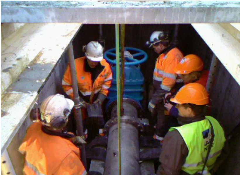
Bilde av den første prototypen under testing i Tevla kraftverk( NTE). Alt installert under bakken.
