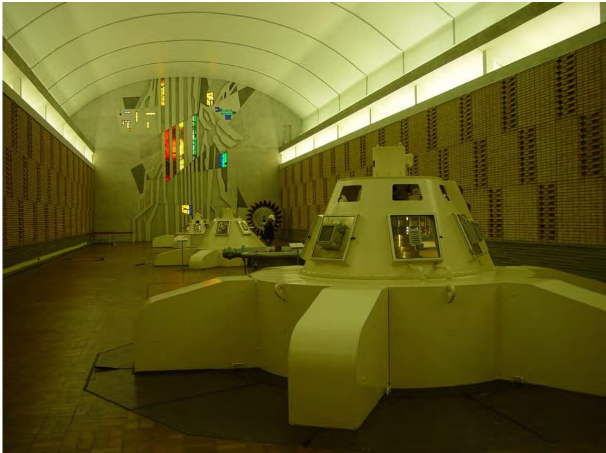
Figur 5 Maskinsal i Evanger kraftverk
