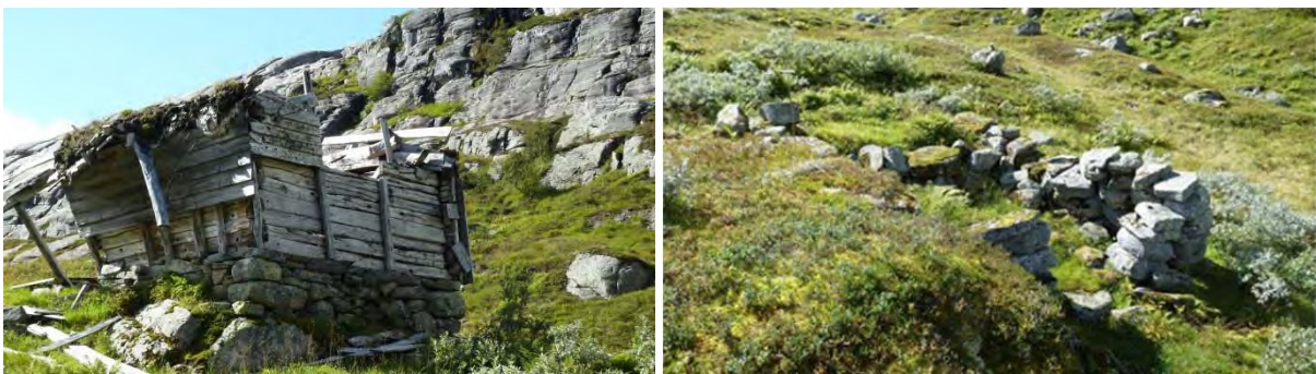
Figur 23. Stølshus som står til nedfalls og ruin etter stølshus på Fjellangsstølen.
