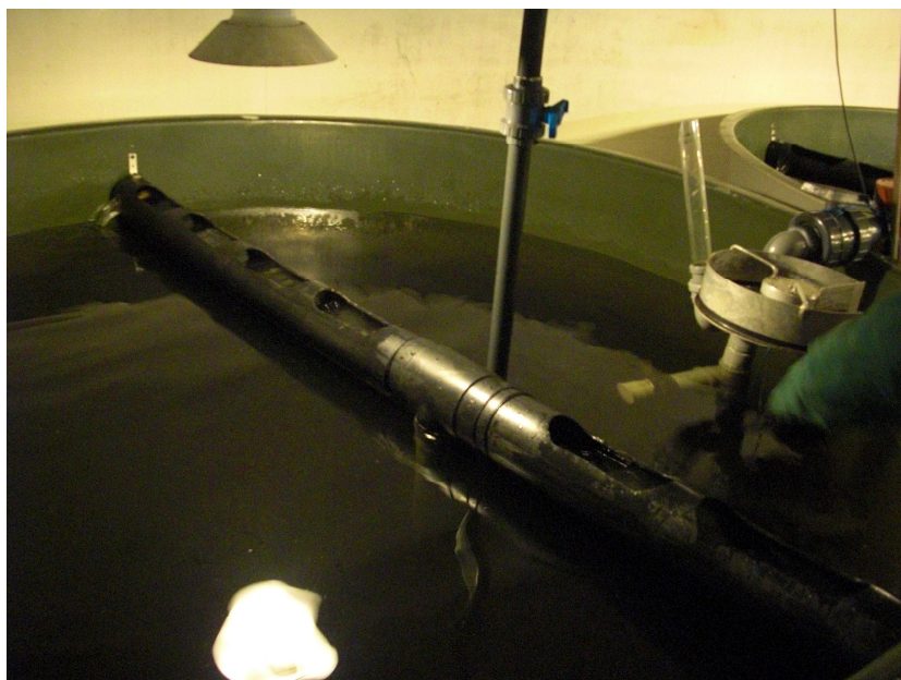
Figur 8 Lufting av vann i kar
