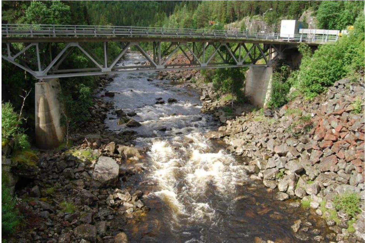
Målt 435 l/s sluppet fra Eikredammen. Regnvær dagen før gir fremdeles økt resttilsig.
