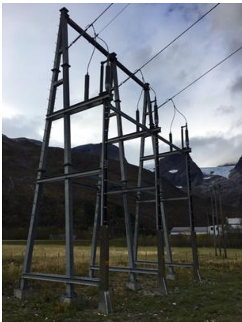
Figur 15. Kabelendemast i stål (bilde)
