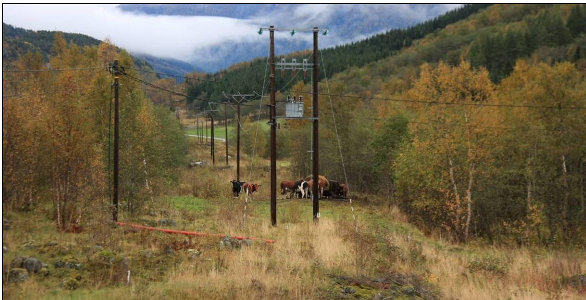
Figur 36. Nettilknytningspunkt ved Brandstad: Denne høyspentledningen ble erstattet med jordkabel i forbindelse med etableringen av Usma kraftverk i 2010. Foto 30. september 2009: Ole Kr. Spikkeland.
