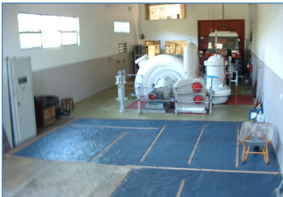
Figur 2.4: Bildet viser dagens aggregat i Hjertvatn kraftverk.
