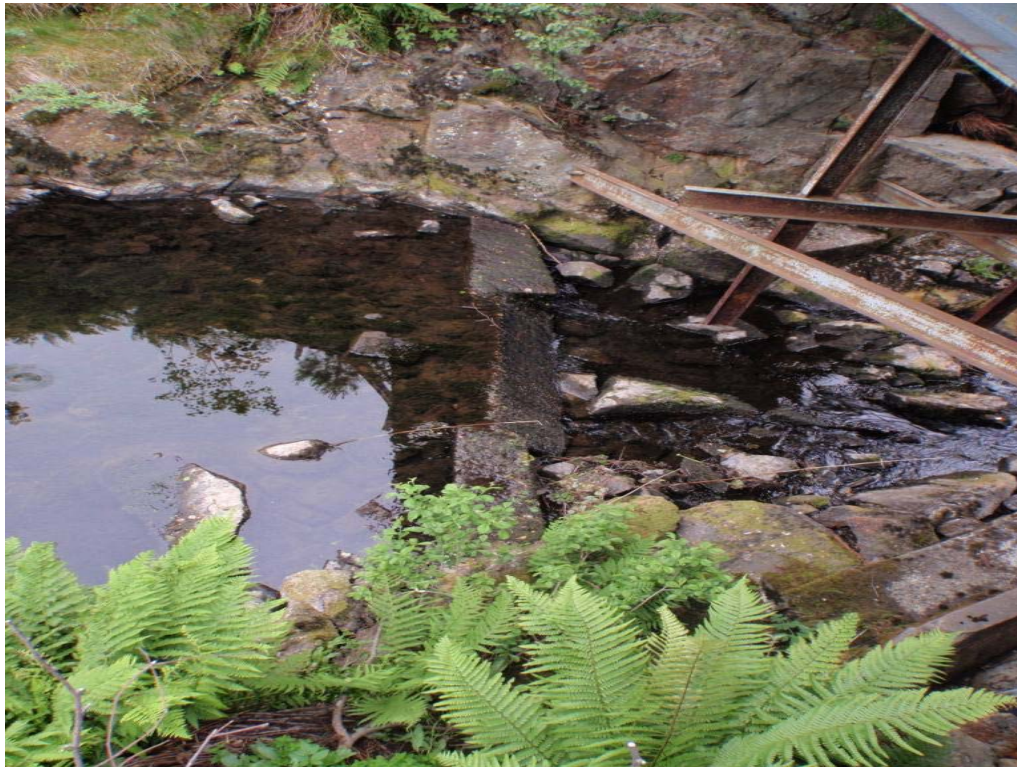
Figur 2: Eksisterande betongterskel, det ligg lausmasser på begge sider av terskel. Terskel er planlagt bytta ut med ny betong dam.
