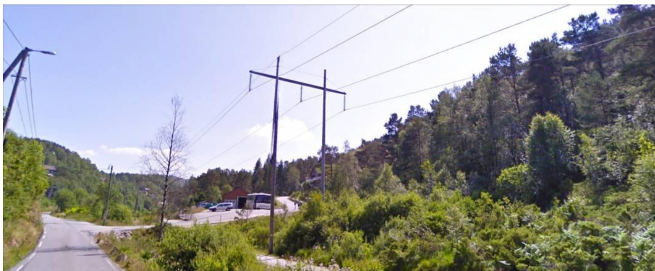
Figur 13. Eksempel på 132 kV H – mast.
