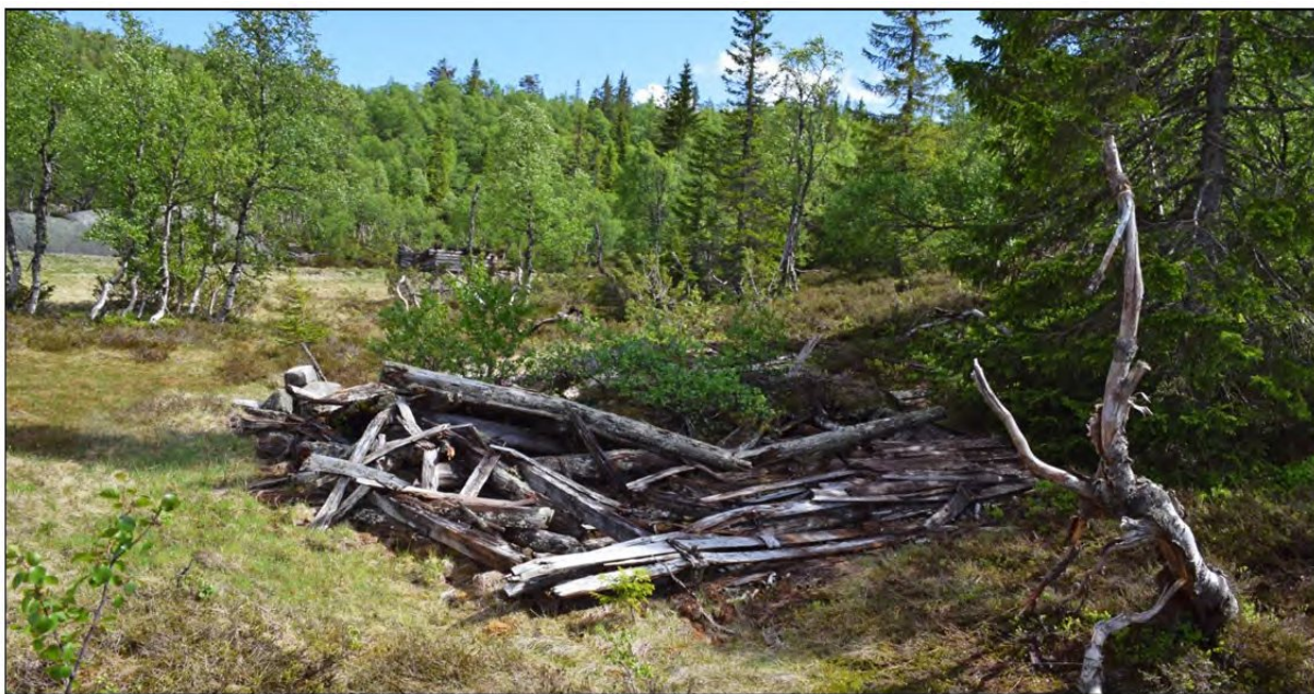
Figur 35. Ruiner på Bleilistøl. Forfallet i bygningsmasse i stølsområdene er stort. Foto: Arnulf Østerdal, Multiconsult
