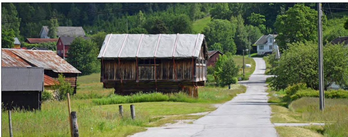
Figur 55. Haugenloftet slik det framstår i dag. Utbedring av loftet pågår. Foto: Arnulf Østerdal, Multiconsult
