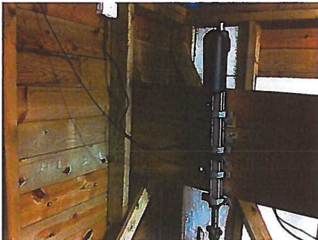
Bilde 4: Motor som styrer ventilen
