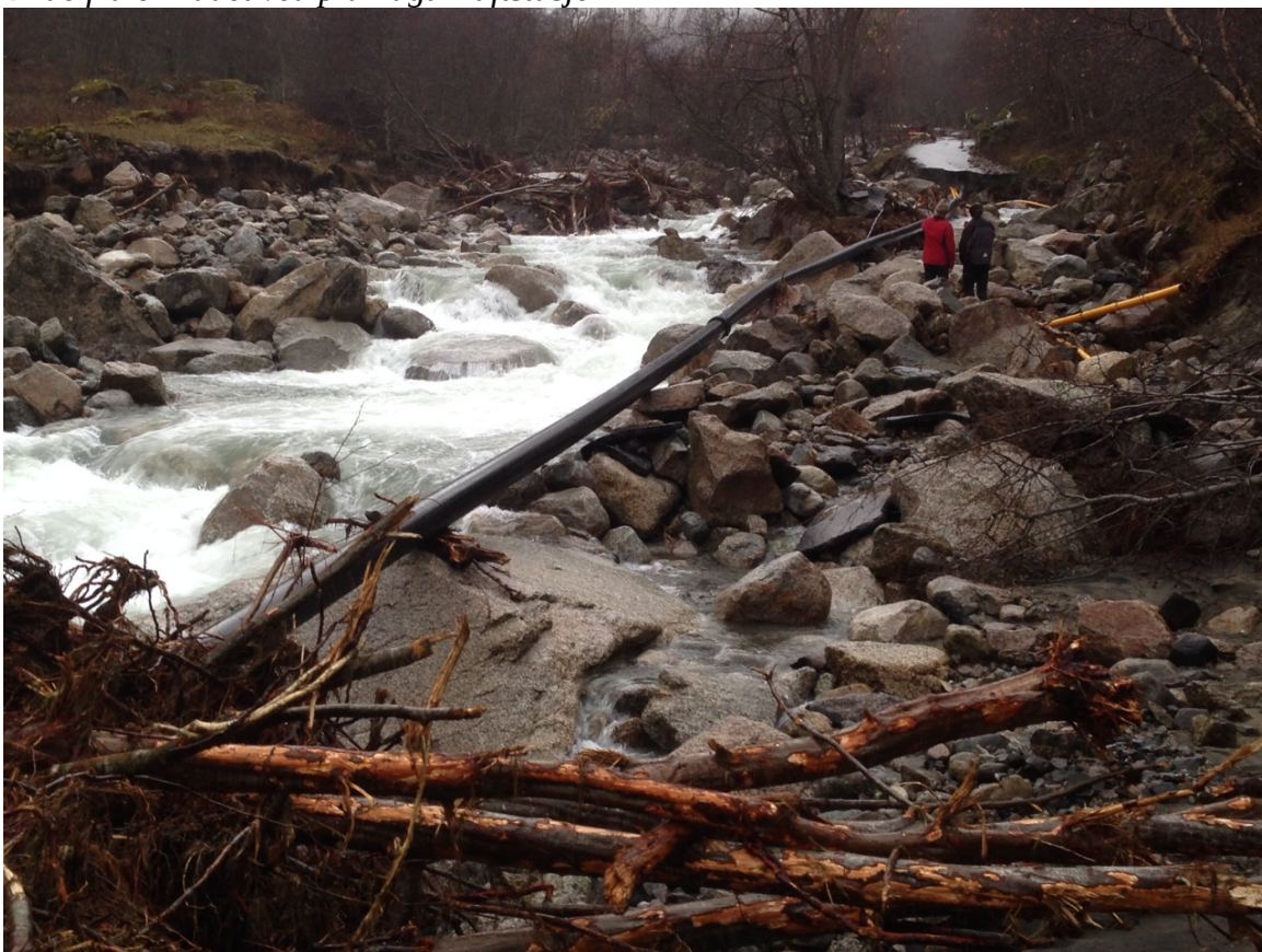
Store skader på vei, kabel og elveleie. Rørledning for vannforsyning til landbruket.
