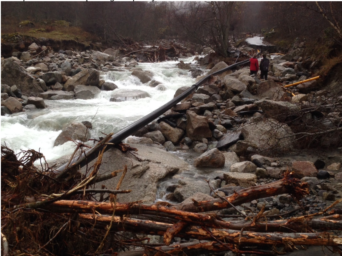
Store skader på vei, kabel og elveleie. Rørledning for vannforsyning til landbruket.
