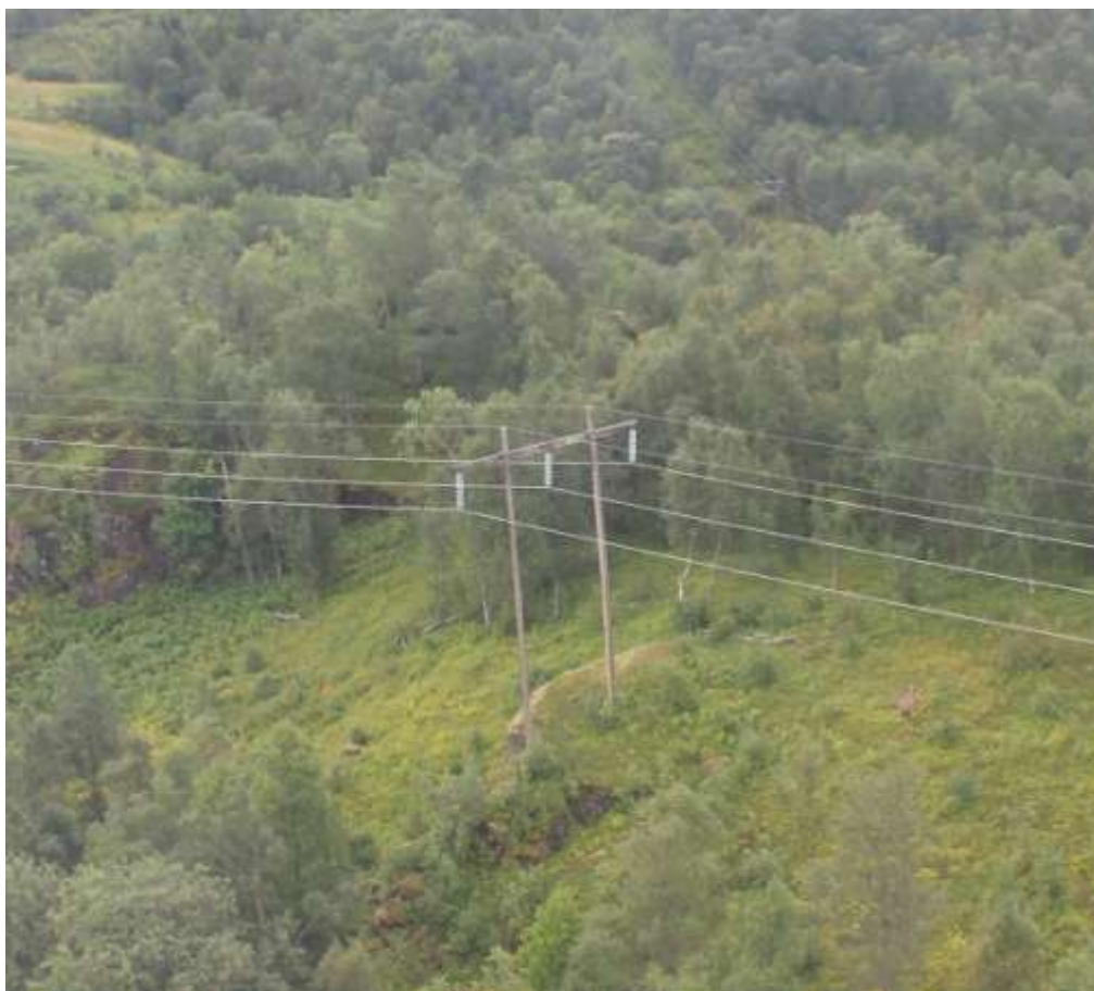
Figur 7. Eksempel på 132 kV kraftledning bygget på H – master av trestolper.
