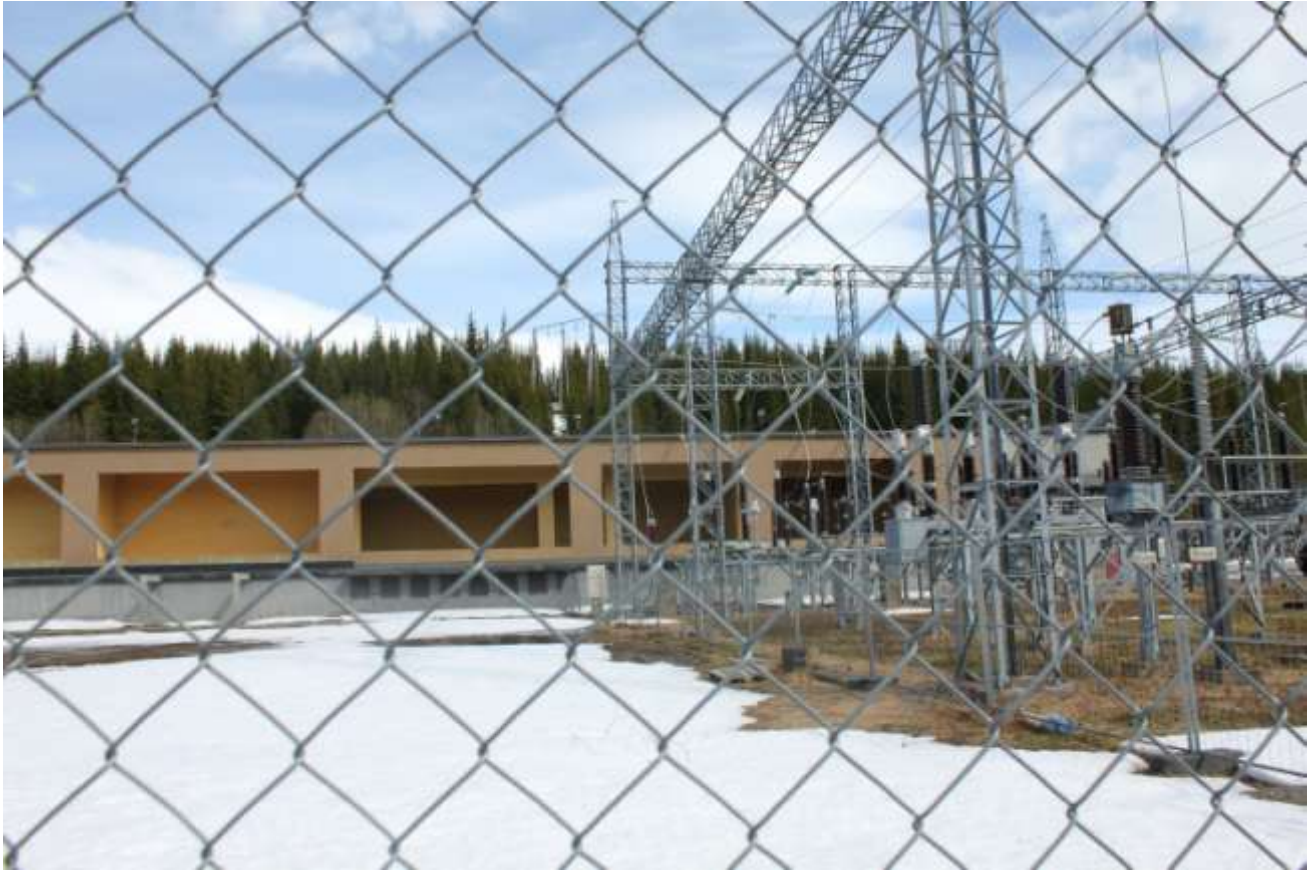
Figur 9. 132 kV anlegget i Nea trafostasjon. Utvidelsen av 132 kV anlegget skjer mot venstre (nord).
