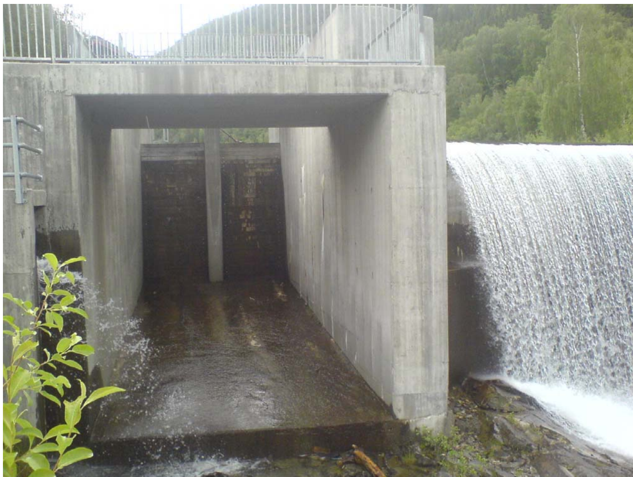
Nedstrøms side med tappeanordning tilrettelagt for påkobling av kraftverk
