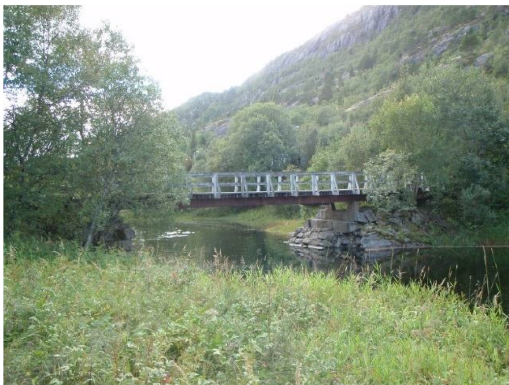
Bilde 10. Bru over Halsanelva. Må muligens forsterkes.
