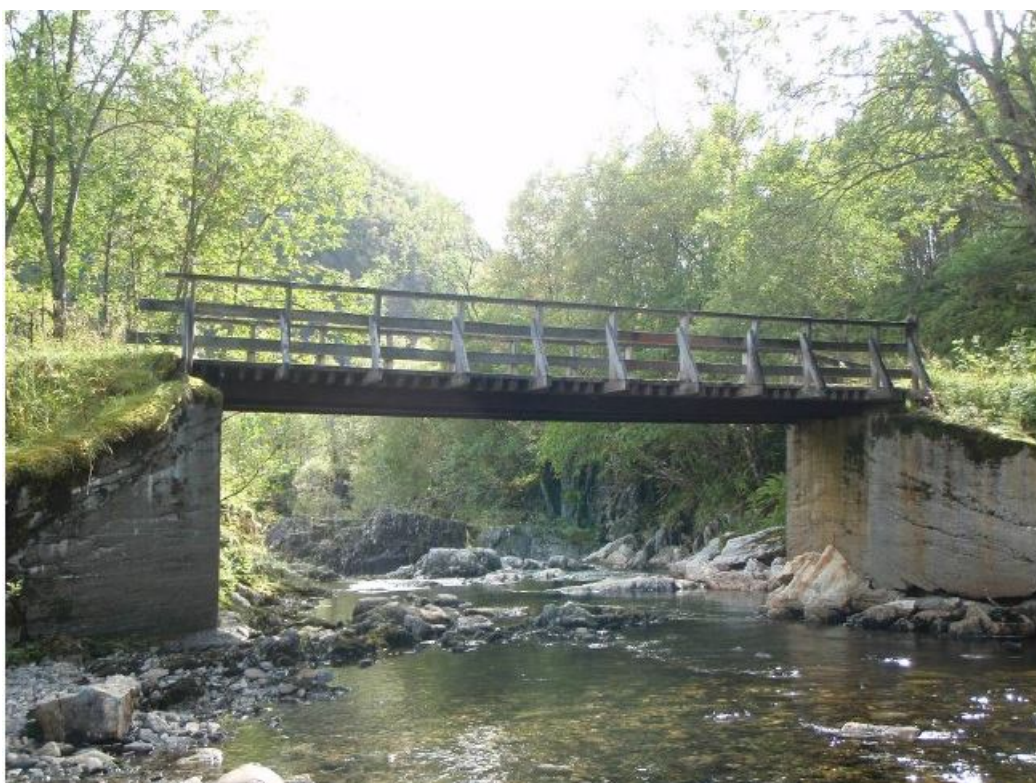
Bilde 6. Bru over elva fram til Forsmoen gård. Brua må oppgraderes.
