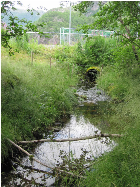
Fig. 6 Øvre enden av Drivo (rør under idrettsbane)
