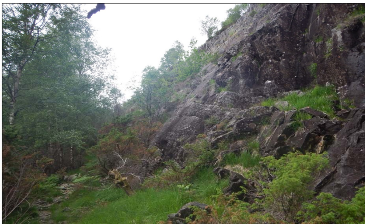
Foto 9. Område D: Bergvegg med fare for steinsprang.
