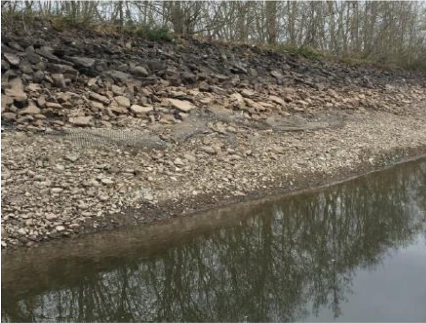
Figur 2-36 Eksisterende erosjonssikring med blottlegging av sikringsnett. Foto: Statkraft 2016.
