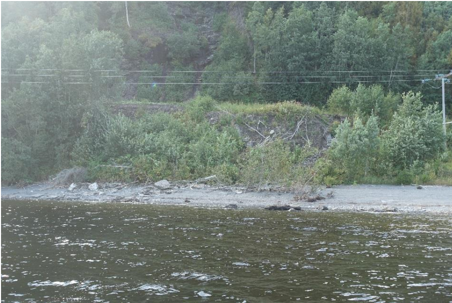
Figur 2-30 Erosjon i fylling mot vei. Foto: OKB
