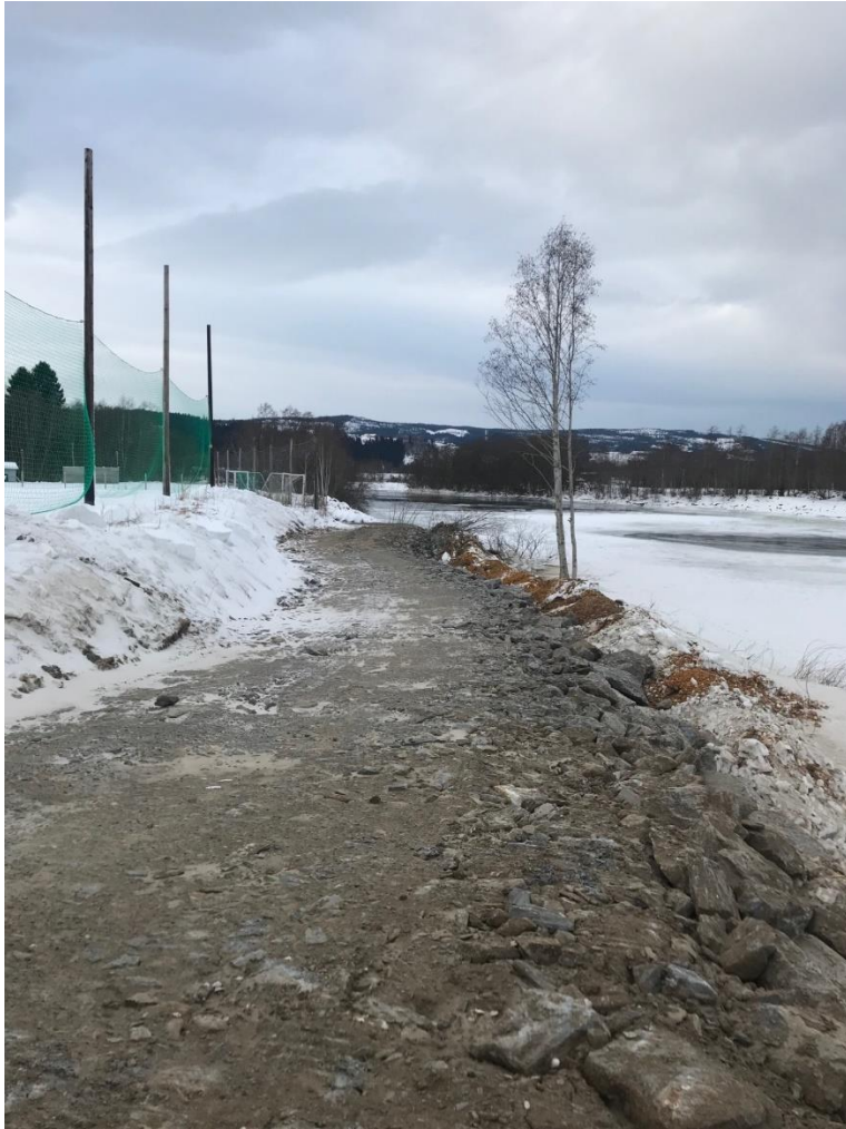
Figur 20 Nea 2019 østre side ved idrettsbane. Utgliding nå reparert.
