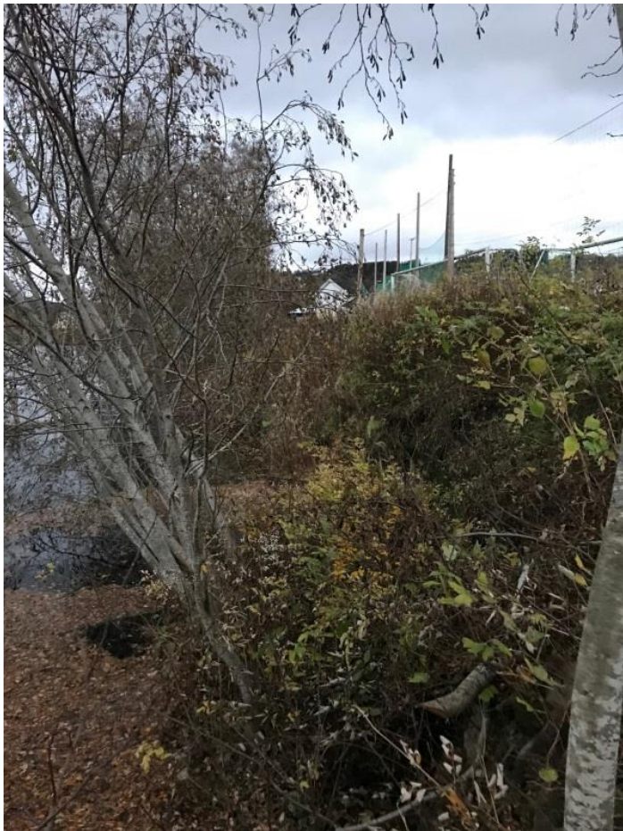
Figur 19 Nea 2019 østre side ved idrettsbane. Utgliding nå reparert.
