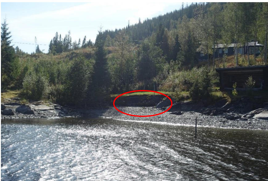
Figur 2-32 Liten erosjonsskade vist med rød ellipse ved fritidseiendom ved Kulvikodden. Foto: OKB
