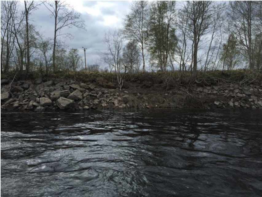
Figur 2-38 Detaljbilde viser mindre skade på sikring på østsiden av Årsøya.
