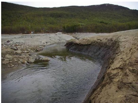
Sideveis erosjon i innløpsområdet
