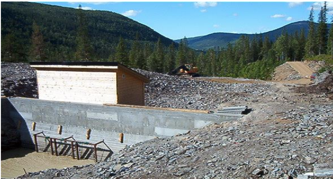
Foto viser inntak til Storrøvatnet kraftverk.
