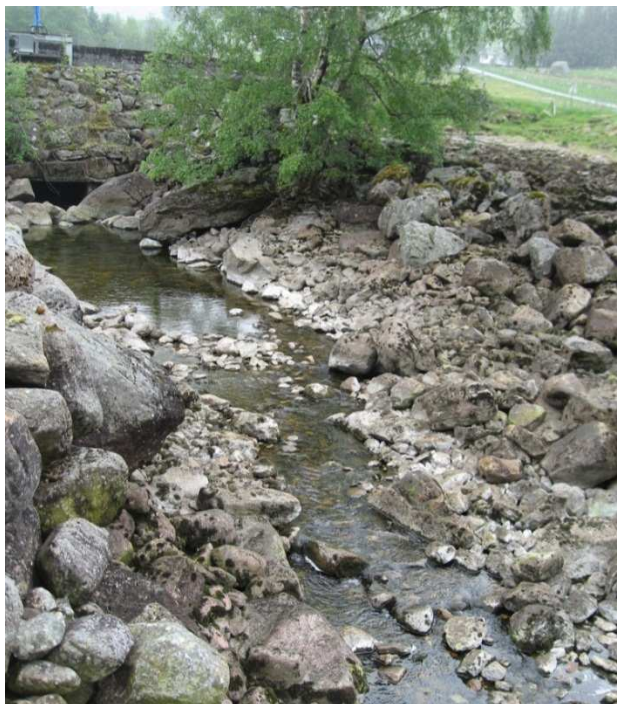
Ca. 0,02 m 3 /s målt ved øvre målestasjon. Luke stengt. Liten lekkasje fra luke. 2013 06 12.
