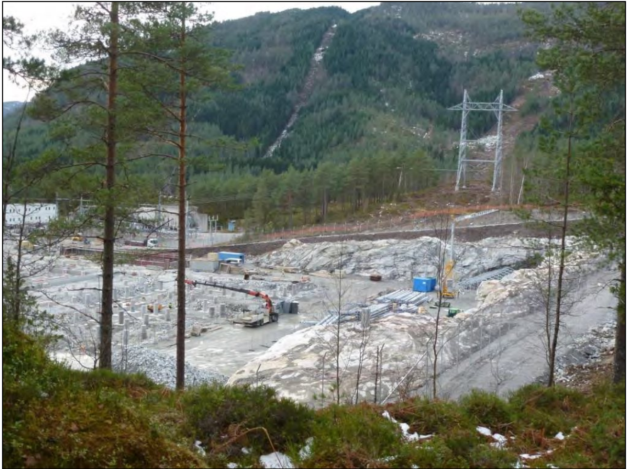
Figur 33. Jordkabelen for nettilknytning vil bli graven ned i Statnett sitt nye trafoområde ved Moskog. Foto: Linn Eilertsen.
