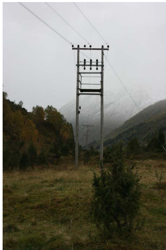
Bilde 5.2 22 kV H-mast ved stasjonen
