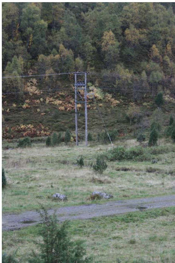
Bilde 5.1 22 kV linje ves stasjon
