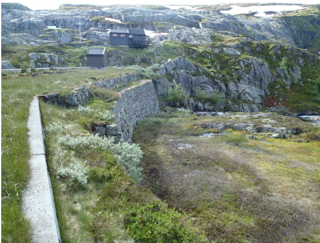
Figur 9-11. Dammen vest i Fossavatnet. Foto: Sweco Norge AS.
