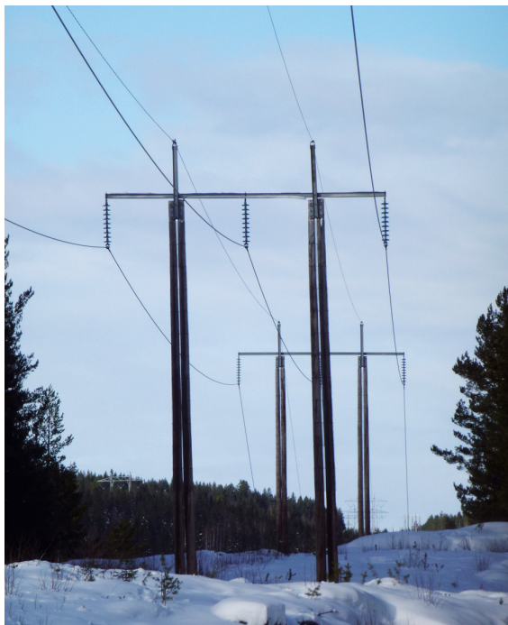
Figur 3. Typisk 132-kV ledning med tremast.
