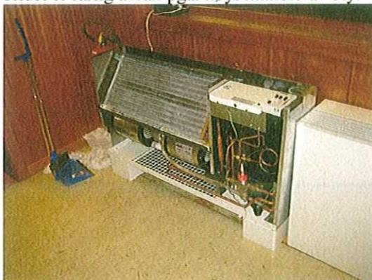
I det gamle kontrollrommet i Blåfalli 2 står en kjøleenhet med HKFK-gass. Vinduene mot maskinsalen har avstandsprofil (mellom glassene) av bly.
