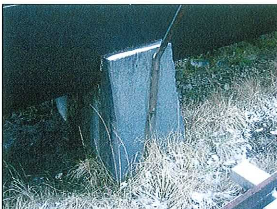
Figur 5 Typisk betongunderstøtting under ett av rørene. Høyden på understøttingen varierer med avstand til bakken.
