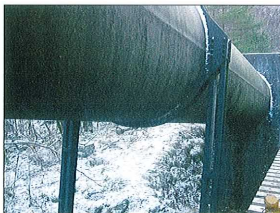
Figur 6 Typisk stålunderstøtting rør 2. Høyden på understøttingen varierer med avstand til bakken.
