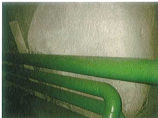
Blåfalli 1 - Kraftstasjon i fjell - Rørisolasjon av cellegummi, her grønnmalt, inneholder bromerte flammehemmere og er derfor farlig avfall.
