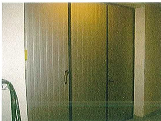
Kjøreport i nederste etasje i Blåfalli 2 er isolert med polyuretan med HKFK-gass.
