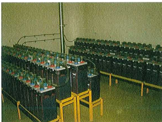
Blybatterier i batterirom. Slike batterirom finnes både i Blåfalli 1 og i Blåfalli 2.
