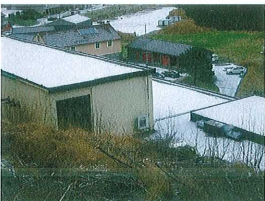
På taket av Blåfalli 2 står et kjøleaggregat med HKFK-gass. Kjølerør er isolert med cellegummiisolasjon med bromerte flammehemmere.
