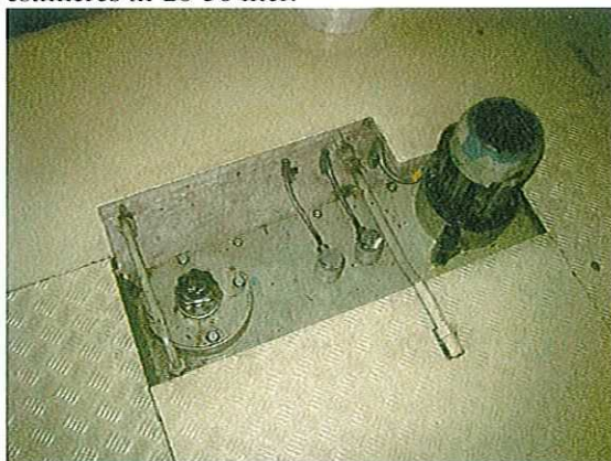
Oljetank for smøring av generatorlager Blåfalli 1.
