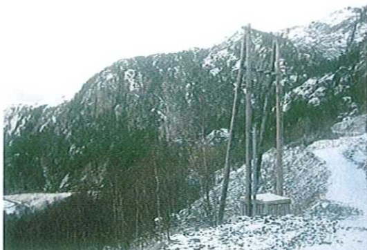
Det er brukt både CCA-impregnerte og kreosotimpregnerte master i anlegget.
