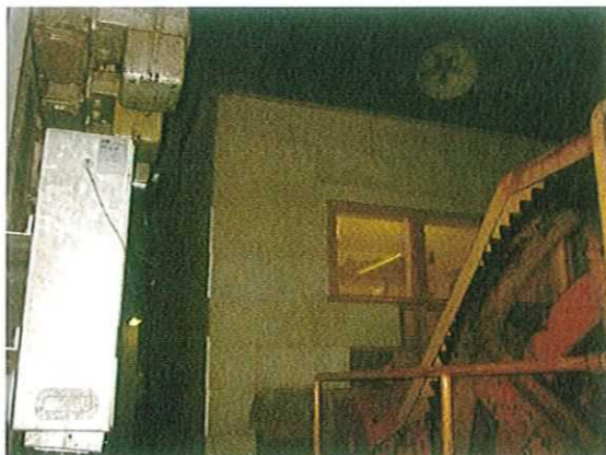
Eternittplater med asbest på spillhus i ventilkammeret. Den sølvfargede malingen på metalldelene til venstre i bildet er farlig avfall pga. høyt innhold av bly.
