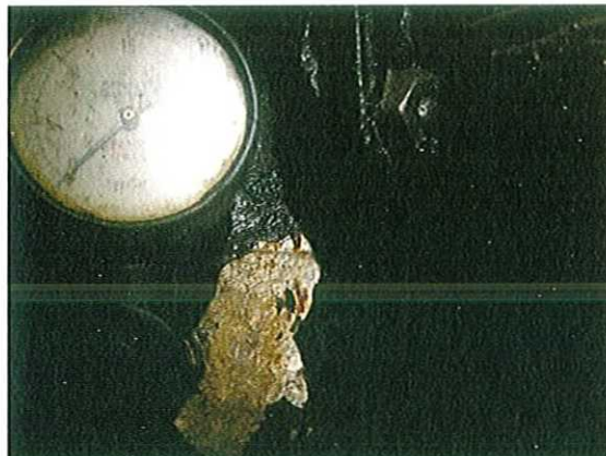
Bildet er tatt i ventilkammeret oppe i fjellsiden. De fleste rørdelene er malt svarte, mens noen er sølvfargede. Den svarte malingen er farlig avfall pga. høyt innhold av PAH. Den sølvfargede malingen er farlig avfall pga. høyt innhold av bly.
