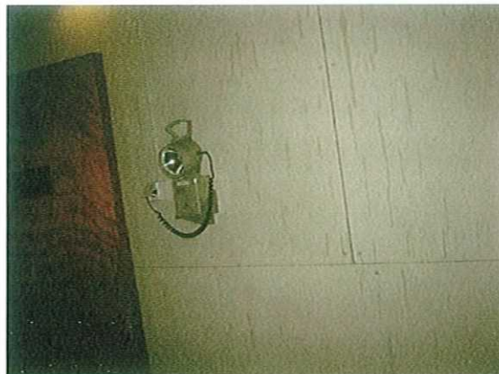
Eternittplatevegg i kraftstasjon Blåfalli 2
