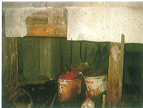
Det finnes olje, maling og kjemikalier i fat, spann, flasker og sekker. Her malingspann i ventilkammeret. Øverst i bildet sees asbestplatene på spillhuset.
