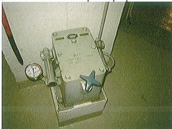
Hydraulisk jekk ved turbin 1 i Blåfalli 2. Oljeinnhold estimeres til 20-30 liter.
