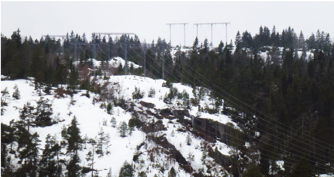
Figur 1. Tre regionalnettslinjer som i dag går fra Senumstad koplingsstasjon inn i Bjelkeberget planområde. Foto: Sweco.
