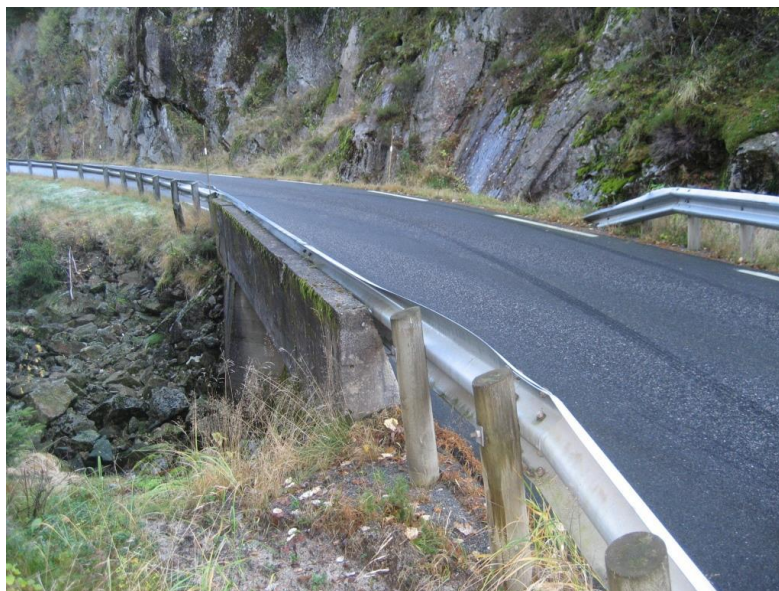
Figur 6-18: Broen på Fv252 ved Trangedal må utvides og forsterkes.
