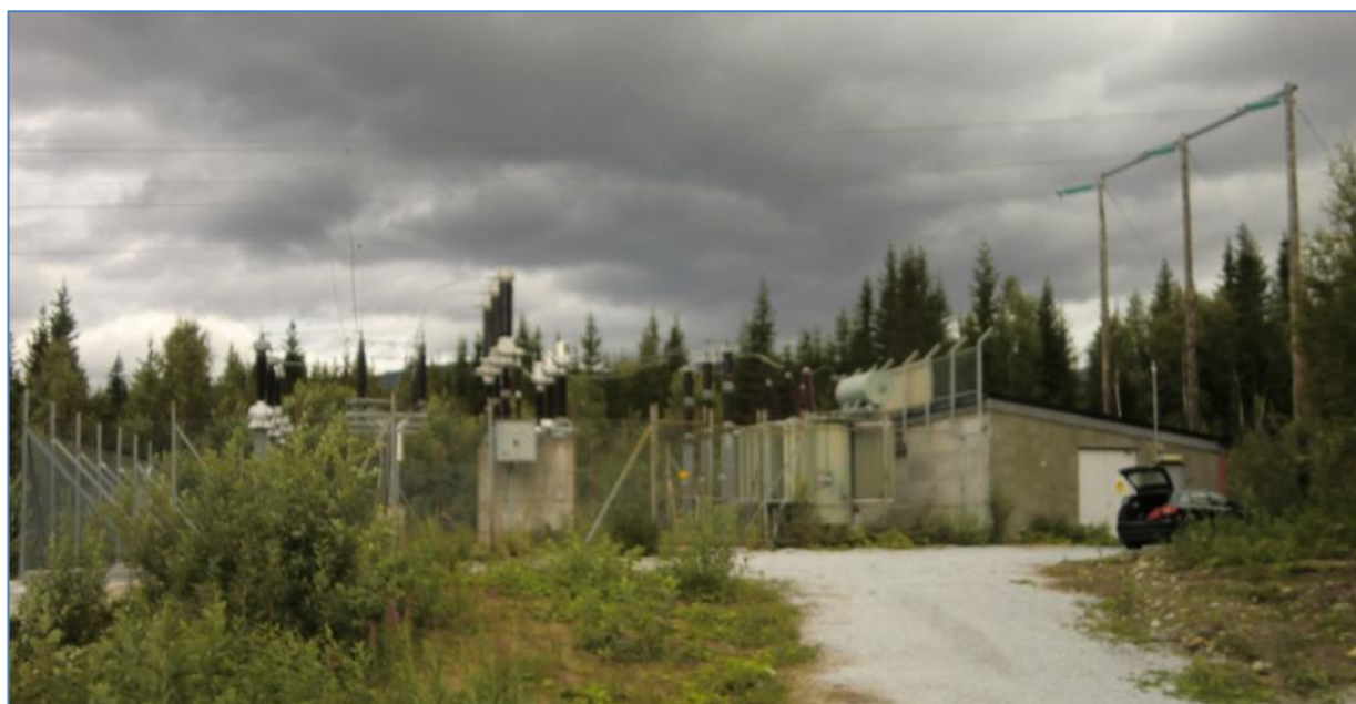
Figur 3-5. Eksempel på utendørs koblingsanlegg. Bilde Sweco
