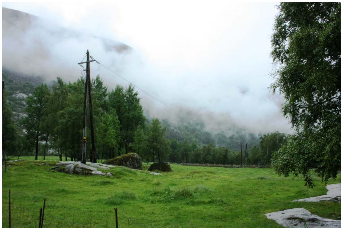
Bilde 6.1 Endemast på 22 kV kraftlinje ved Nes gård
