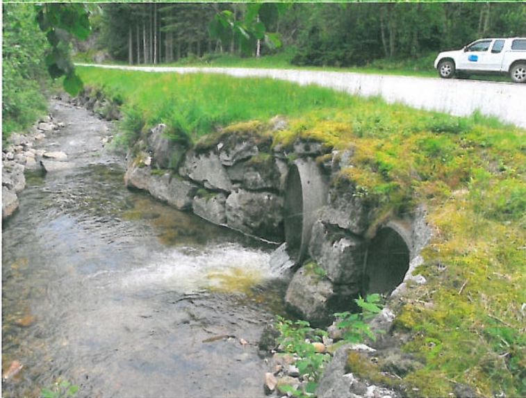
Tysdalselva i rør under riksvei 13
