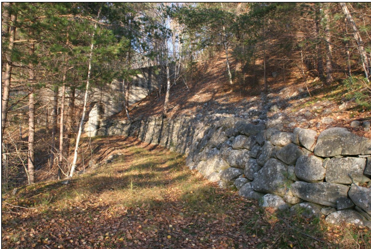
Fig. 40. Deler av strukturer knyttet til gruveanlegget nederst i influensområdet. 24. okt. 2011. Foto: A. Håland©.
