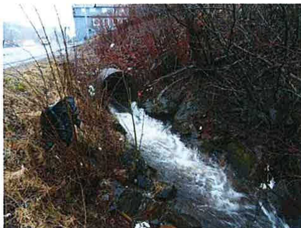
Overvannsrør Ø = 1,4 m. oppstrøms Storavatnet.
