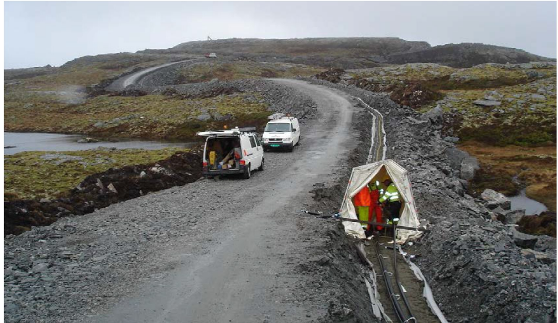
Figur 3: Internvei inkl kabling i et vindkraftverk. Foto: Rambøll
