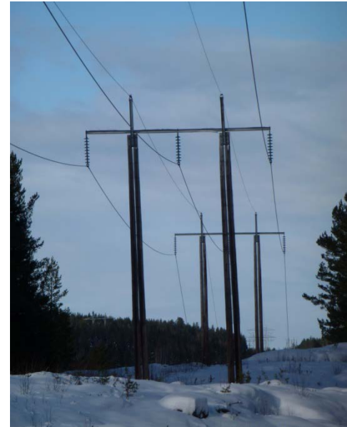
Figur 3. 132-kV linje med tremast. Typisk høyde for disse master er 12-18 m.
