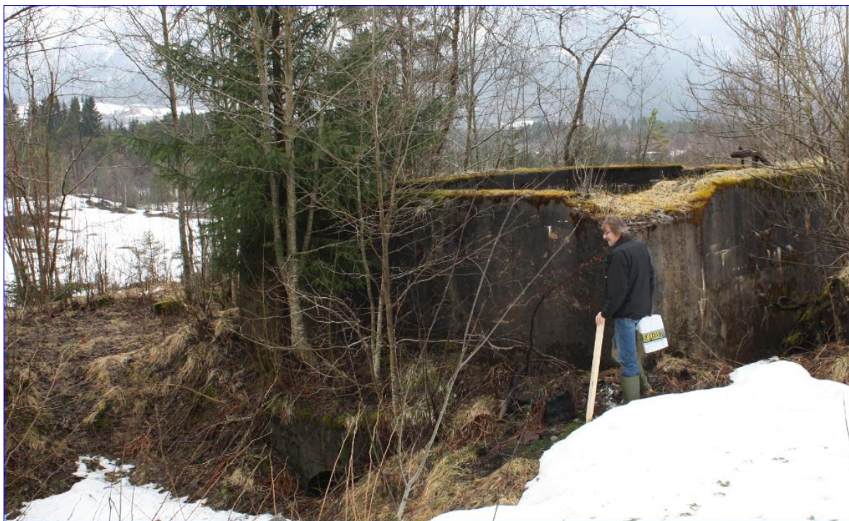
Figur 2.2.5.3 Foto viser inntaksbassenget / reguleringskum til det gamle Kavlifoss minikraftverk.
